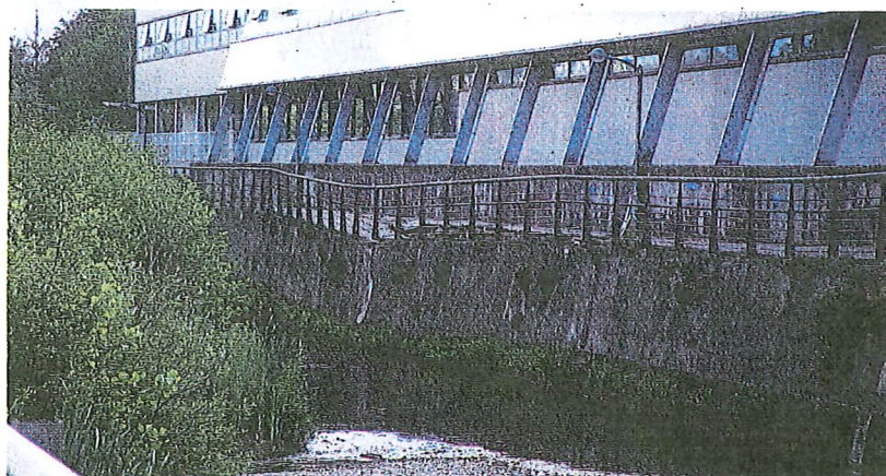
Tramo de senda afectado en enero por un hundimiento, junto al pabellón verde del Grupo. PALOMA UCHA
